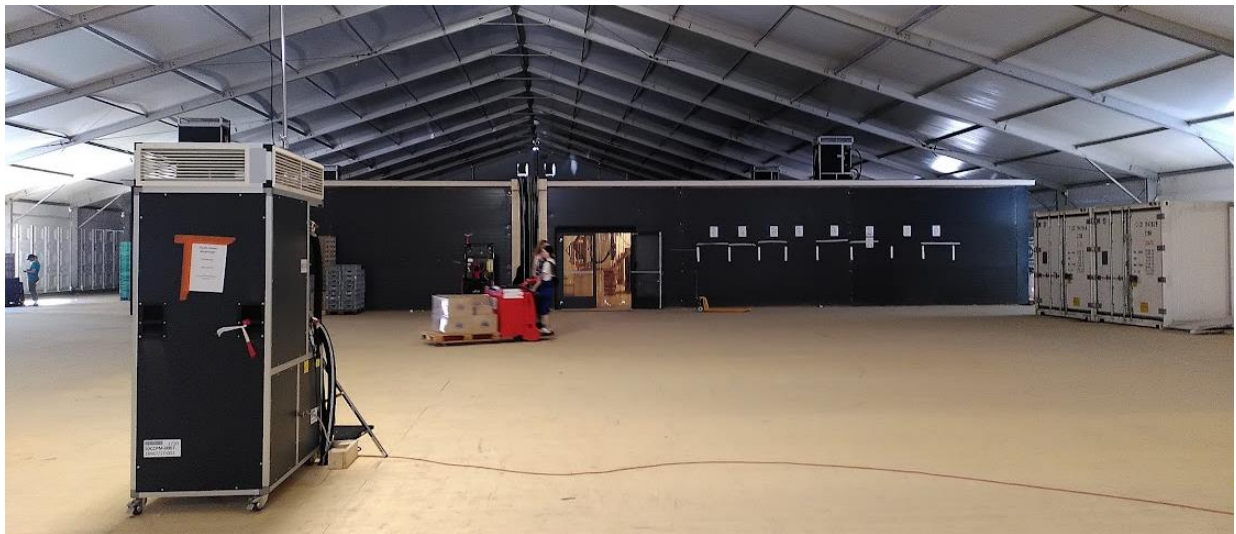
Foto 41: Blick in die (leere) Verpflegungszentrale mit Rückkühler im Vordergrund und Kühlhalle (mit schwarzen Panelen isoliert) (Mischa Kaspar / Monti)
